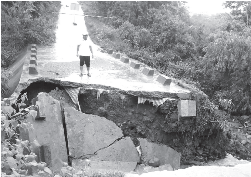
Cống tràn bị sập khiến 3 thôn ở xã La Lay bị chia cắt - Ảnh: S.H
