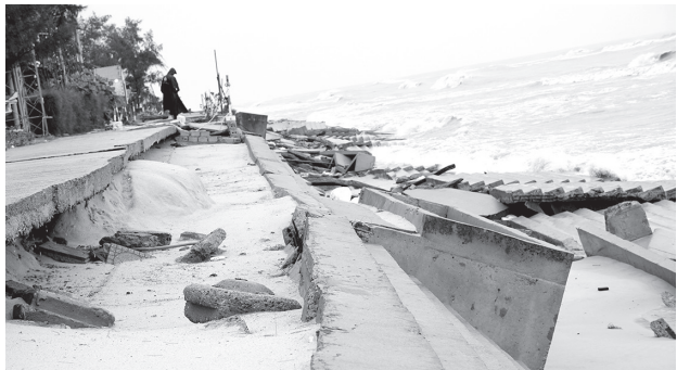
Khoảng 500m kè biển Nhật Lệ (Hải Thành-Quang Phú) bị sóng đánh sập hoàn toàn -Ảnh: H.TR
