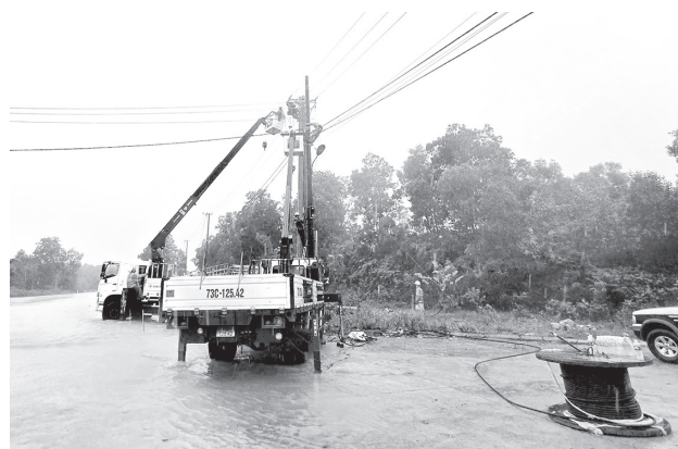
PC Quảng Trị khẩn trương khắc phục sự cố hệ thống lưới điện do bão số 10 gây ra - Ảnh: V.M
